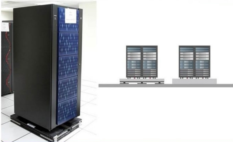
ตัวอย่าง Base Isolation รองรับอุปกรณ์คอมพิวเตอร์ไฮเทค ใน Data Center
