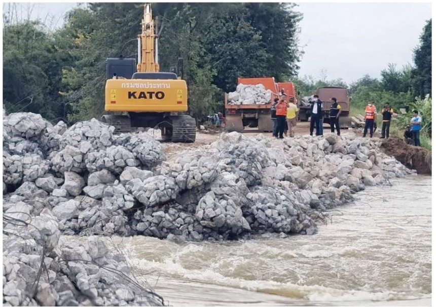
☰ ซ่อมเสร็จ - เจ้าหน้าที่ระดมซ่อมพั้งกั้นน้ำชีขาด บริเวณหลักกม.ที่ 6 บ้านสะคำศรี ต.ลำชี อ.สังขชัย จ.กาฬสินธุ์ จนเชื่อมต่อได้สำเร็จใช้เวลา 1 สัปดาห์ ชาวบ้านสามารถกลับมาใช้ สัญจรไปมาได้อีกครั้ง เมื่อวันที่ 25 ต.ค.
